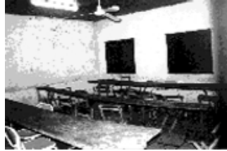
Aula en "El Zanjón", donde vendría bien una mano de pintura
